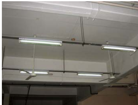
รูปที่ 3-4 สภาพการใช้หลอดไฟก่อนการปรับเปลี่ยน
