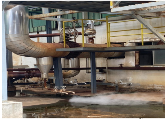
ก่อนปรับปรุง มีการรั่วไหลของไอน้ำ
