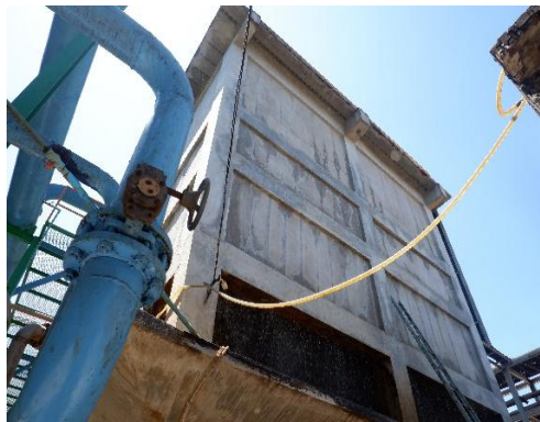
หอหล่อเย็น turbine
