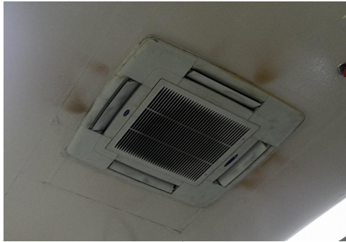
คอยล์เย็นของเครื่องปรับอากาศ
