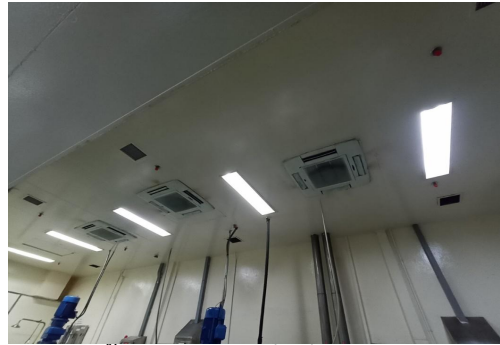
การกันห้องจัดแบ่งพื้นที่ปรับอากาศ
