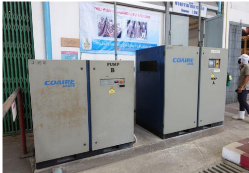
เครื่องอัดอากาศของโรงงาน
