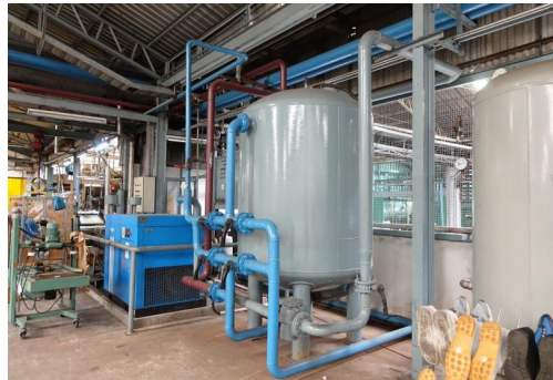
ท่อส่งจ่ายอากาศอัดและถังลม
