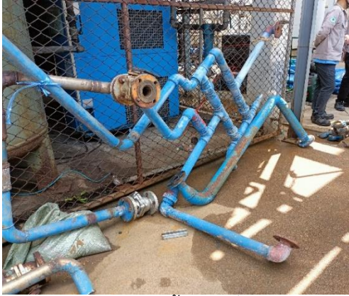
ก่อนปรับปรุงน้ำมีการรั่วไหล
