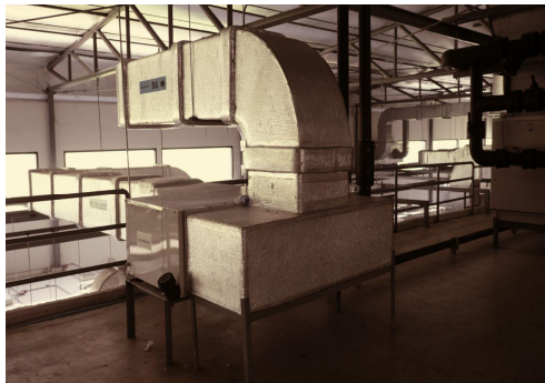
ห้องใต้หลังคาที่ดึง fresh Air เข้า AHU
