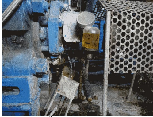
น้ำระบายความร้อน
