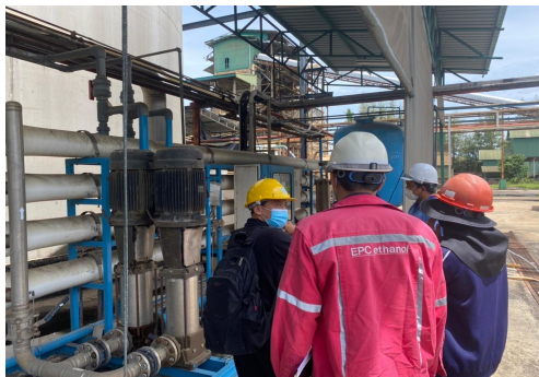
ระบบปั้มน้ำ RO
