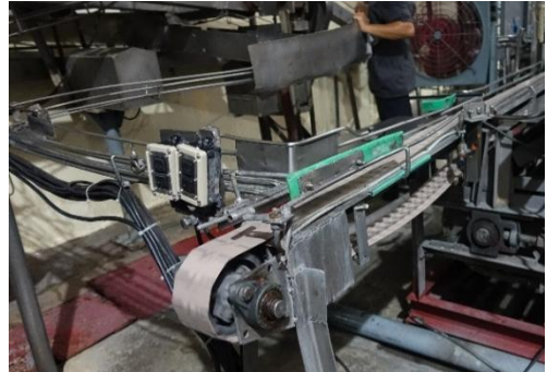
สายพานที่ถอดจุดเป่าลมออก
