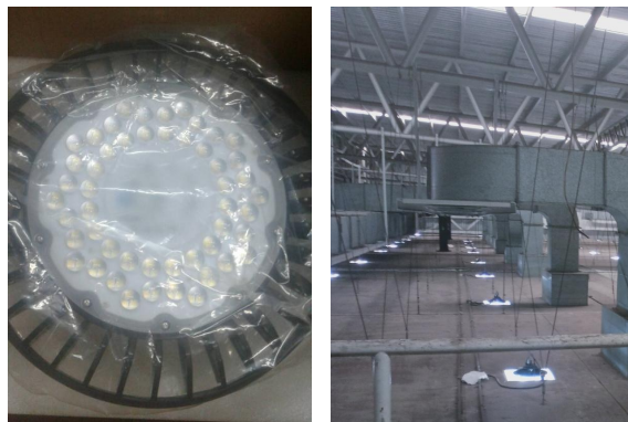
หลอดไฟฟ้า LED ที่ดำเนินการปรับเปลี่ยนในโรงงาน
