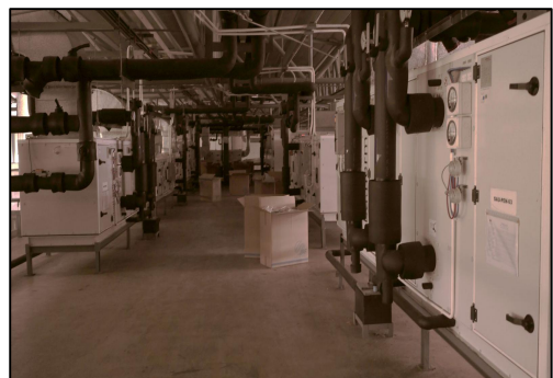
AHU ที่ติดตั้งบริเวณห้องใต้หลังคา
